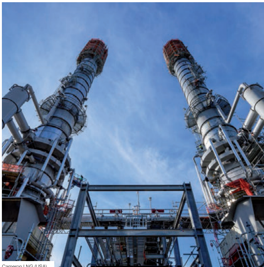
Cameron LNG (USA)
