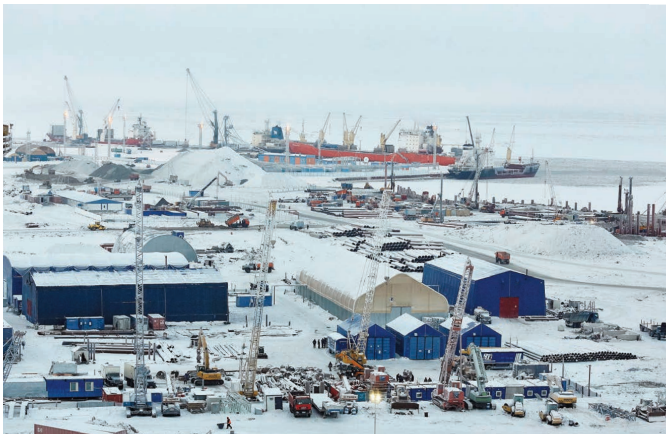
Station de production de gaz naturel liquéfié Yamal, Russie.
