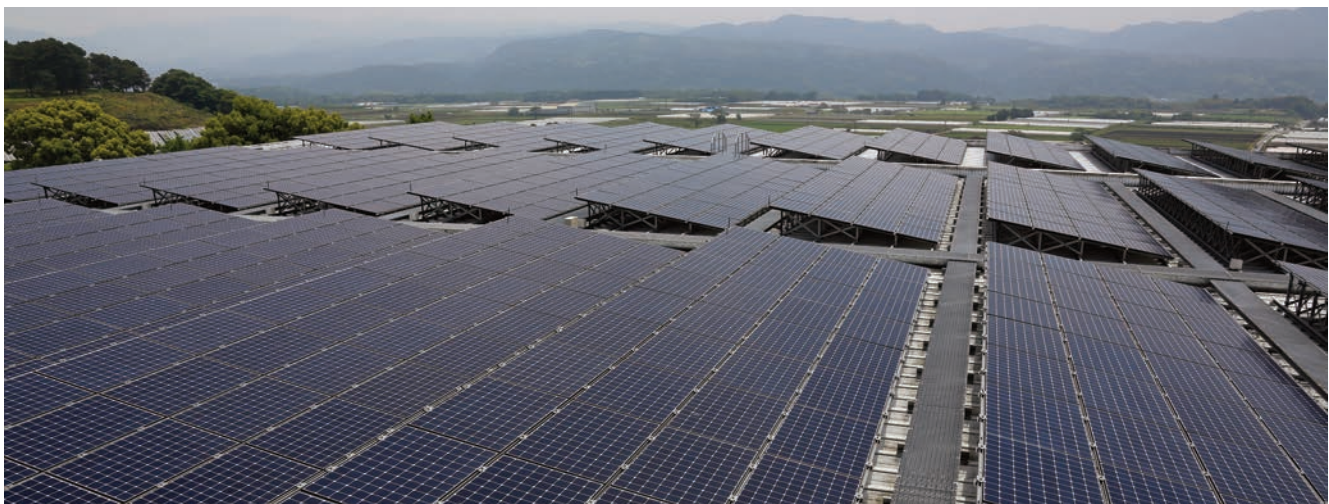
Panneaux solaires SunPower, Kumamoto, Japon.
