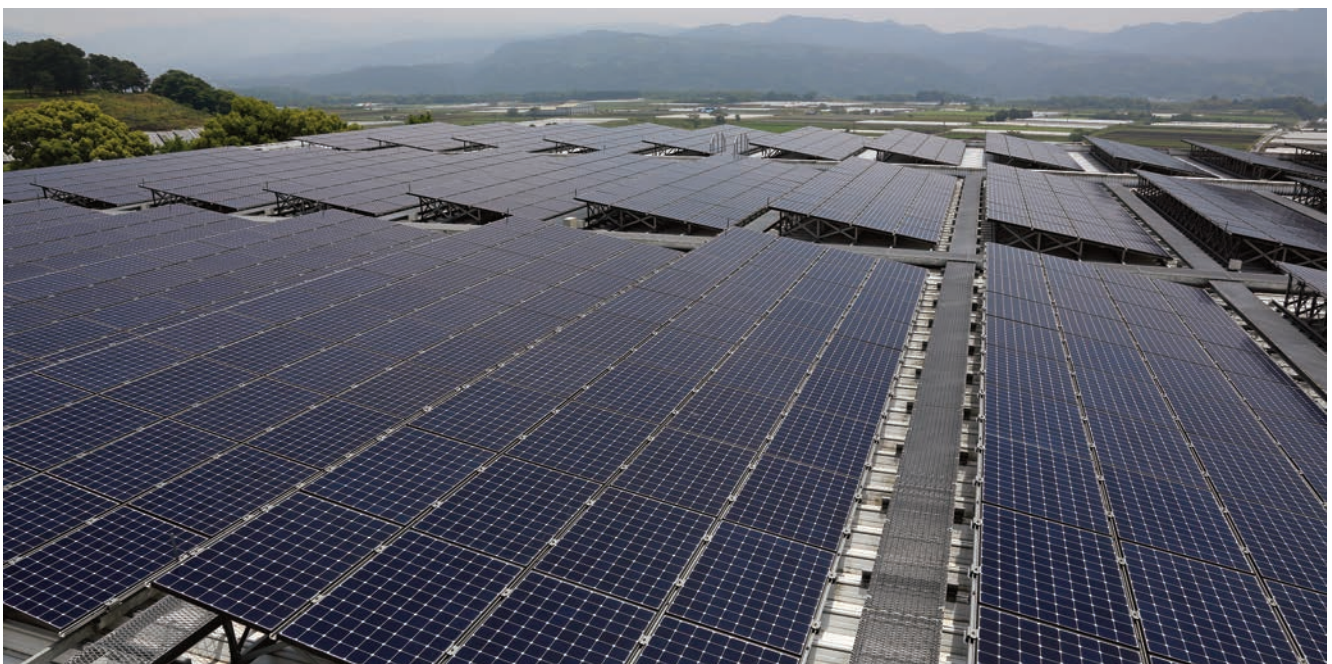
Panneaux solaires SunPower, Kumamoto, Japon.
