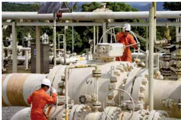
Unité de traitement du gaz, Myanmar.
